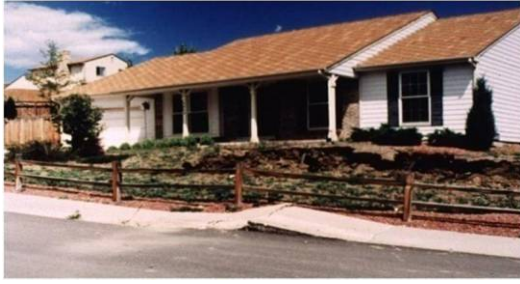
Gambar 5. Tipikal kerusakan jalan akibat besarnya gaya pengembangan tanah subgrade
