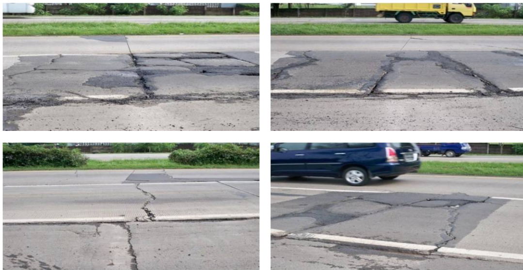
Gambar 1. Tipikal kerusakan jalan akibat kualitas subgrade yang tidak baik
